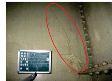
疲労による亀裂発生例
