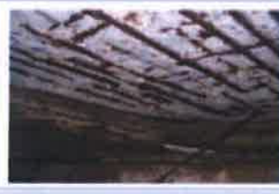
塩害により鉄筋がむき出し
