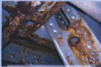
支柱のさびが進行
